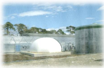
バイオガスプラント
